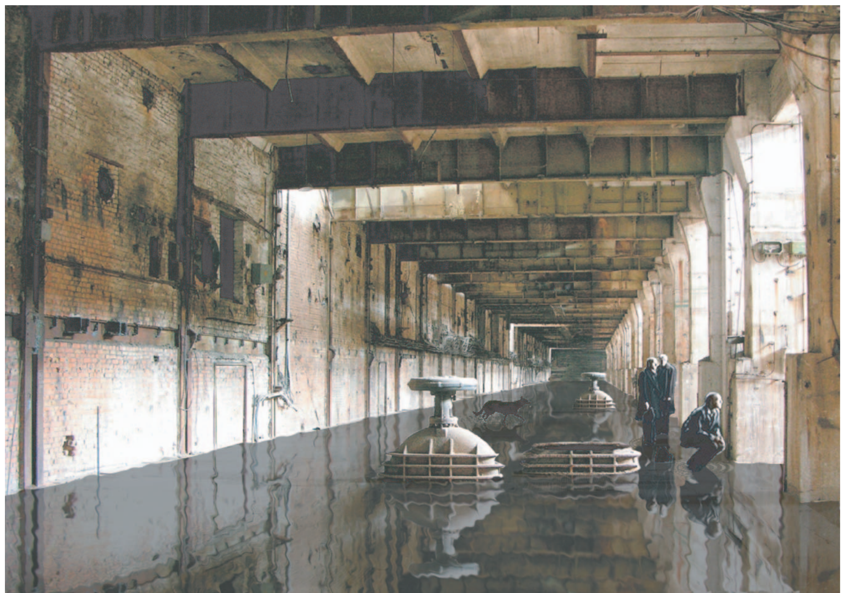
Unangenehme Überraschung: die komplette untere Ebene der Maschinenhalle ist geflutet
